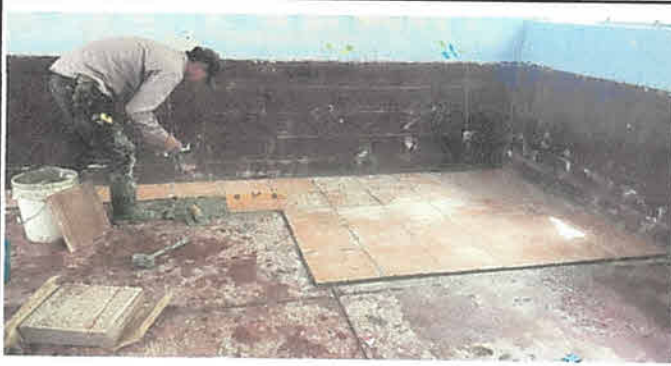
Foto1: Mejorar el piso actual, instalando piso ceramico.
