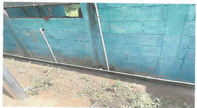
Foto 4: Sistema hidraulico colapsado.
