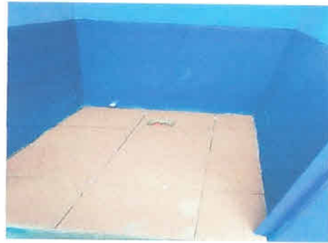
Foto 2: Servicios sanitarios colapsados
